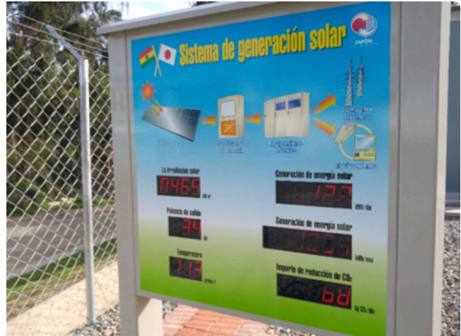
Fotografía 3. Panel de información de parámetros de la Central Solar Fotovoltaica
