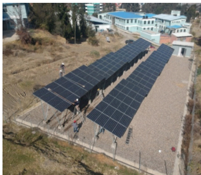
Fotografía 1. Central Solar Fotovoltaica emplazada en el Campus Universitario de Cota Cota, Facultad de Ingeniería UMSA
