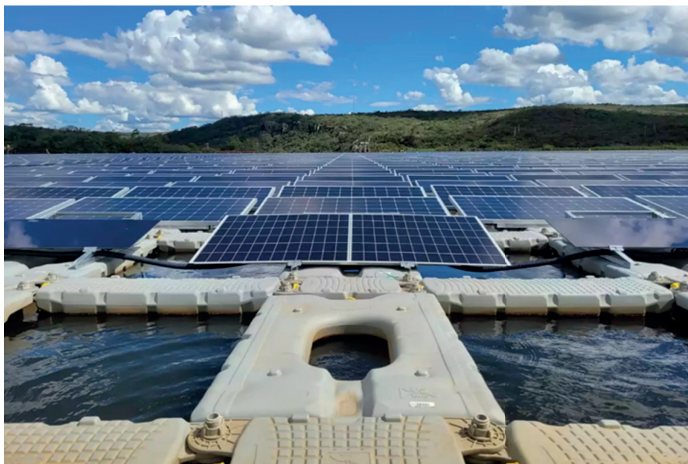
Figure 3 - Veredas Sol and Lares floating solar power plant, in Minas Gerais (Cemig/Divulgação, 2023)
